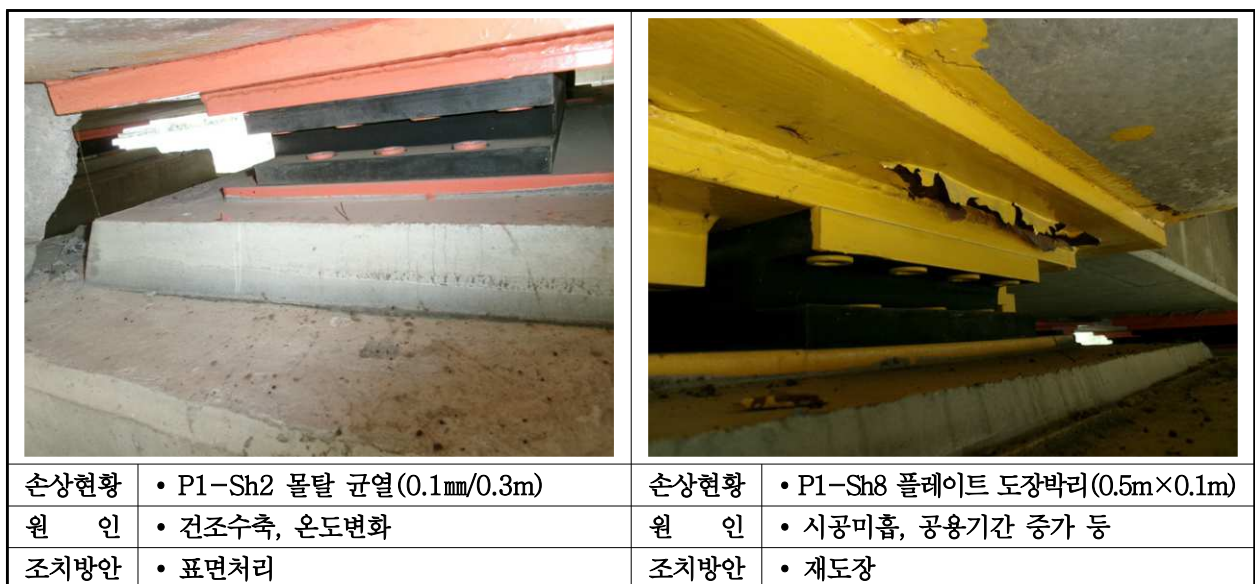
【사진 17.3.13】 교량받침 손상현황
